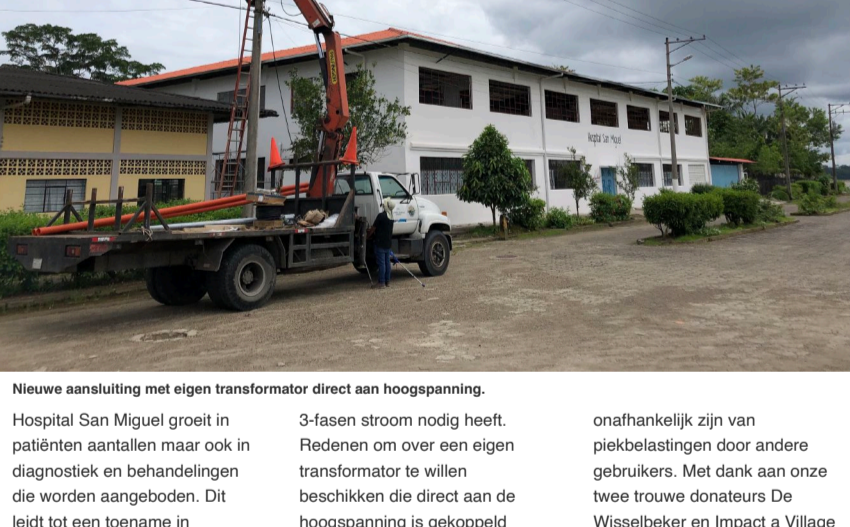
Nieuwe aansluiting met eigen transformator direct aan hoogspanning.
